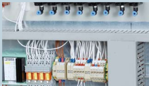
Dank der Verkabelungslösung von pema werden die Fertigungszeiten um ein Vielfaches reduziert.
